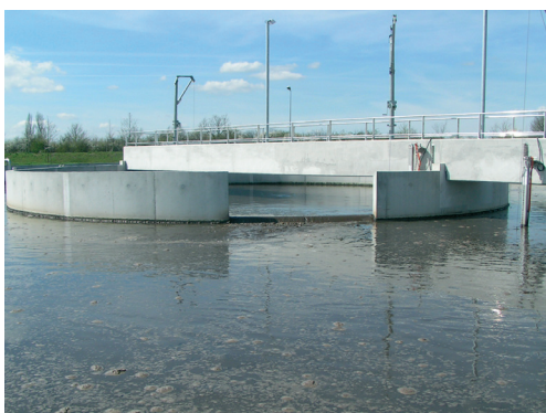
Bassin d'aération de la station d'épuration de Saint-Paterne (72)
