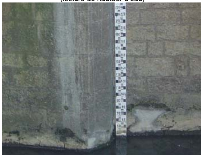
Échelle limnimétrique (lecture de hauteur d'eau)
